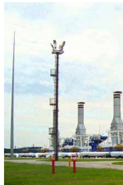
Рис. 2. Мачта с прожекторами на площадке КС
