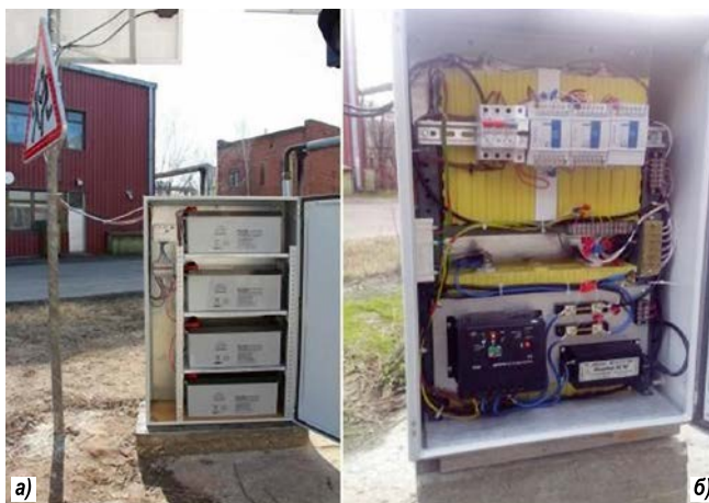
Рис. 3. Блоки накопителей со свинцово-кислотными (а) и литий-ионными (б) аккумуляторами
