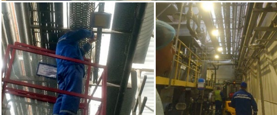
Рис. 3. Процедура изъятия светильников NR-FLW70 с серийными номерами 23718, 23772, 23777 для испытаний из осветительной системы цеха
