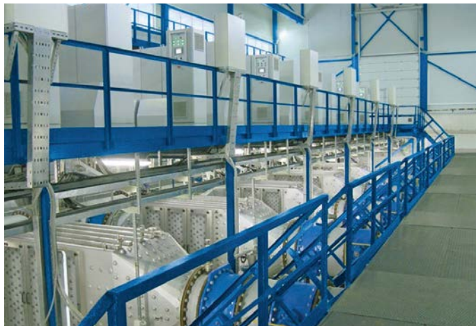
Рис 1. УФ система обеззараживания на Северной водопроводной станции (г. Санкт-Петербург) производительностью 1 584 000 м 3 /сут. (Всего 3888 ламп типа ДБ350, суммарная потребляемая мощность 1,36 МВт)
