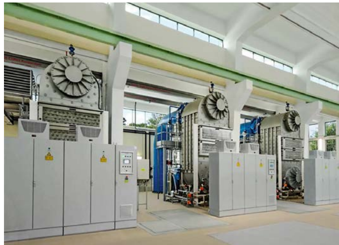
Рис 2. Станция УФ обеззараживания поверхностной воды (г. Будапешт, Венгрия). (Всего 600 ламп типа ДБ350, суммарная потребляемая мощность 210 кВт)
