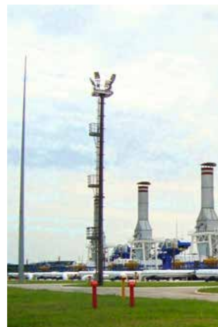
Рис. 2. Мачта с прожекторами на площадке КС
