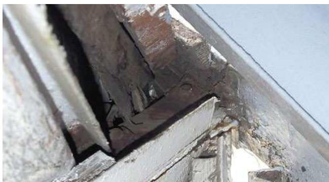
Рис. 4. Узел стропильной балки со следами коррозии
