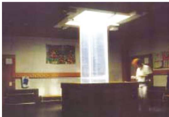
Рис. 6. Вид светящейся части установки «Heliobus» внутри здания
