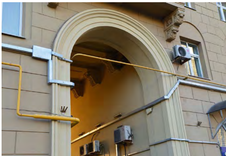
Рис. 10. Качество монтажа и эстетический внешний вид кабель-каналов на Зубовском бульваре (городская программа освещения) – no comment
