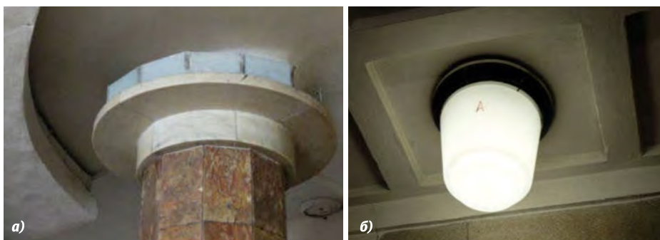
Рис. 4. Сохранившиеся на сегодняшний день первые ОП станции «Красносельская»: а – пластины молочного стекла, используемые для светового оформления лестничного марша; б – светильники зоны перехода
