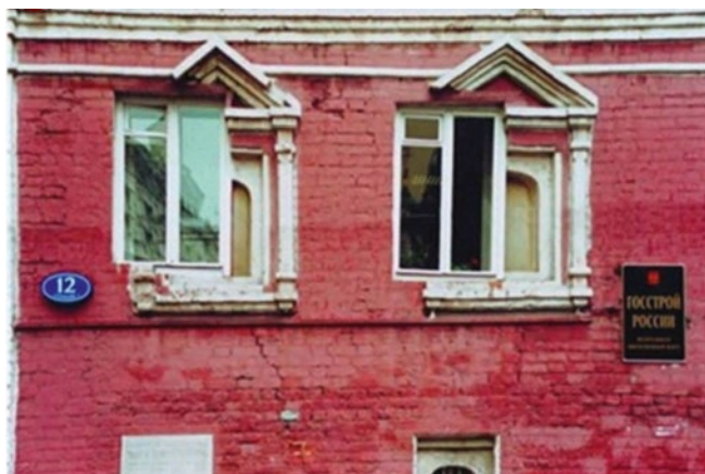
Рис. 3. Удивительная «реставрация» светопрозрачных конструкций
