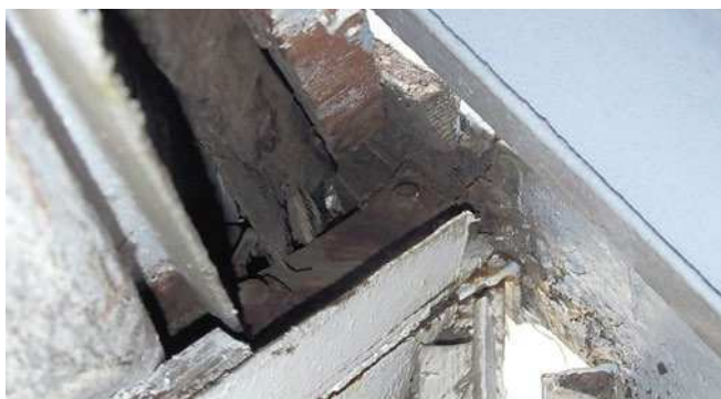
Рис. 4. Узел стропильной балки со следами коррозии
