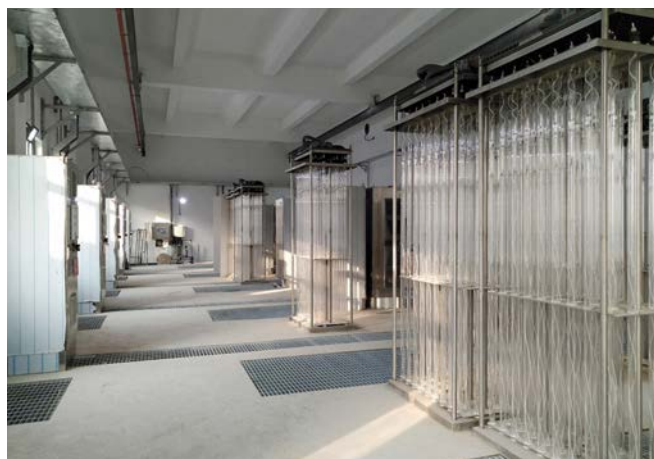
Рис. 4. Станция УФ обеззараживания сточной воды (г. Пекин). (Всего 864 лампы типа ДБ900НО, суммарная потребляемая мощность 700 кВт)
