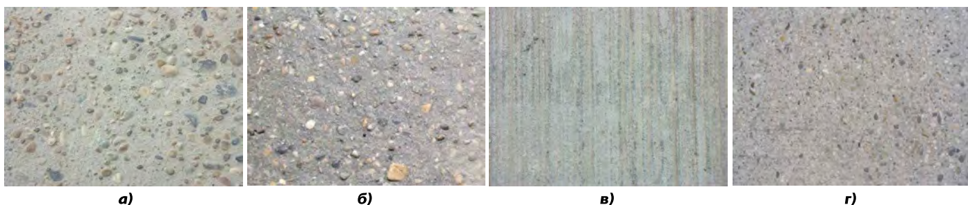
Рис. 6. Фотографии обработанного струёй воды бетона (а – исходное состояние, б – после 2-х лет) и обработанного щёткой бетона (в – исходное состояние, г – после 2-х лет)
