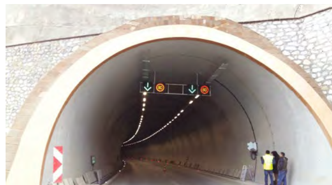
Рис. 5. Освещение тоннеля Buzlupınar светильниками с СД
